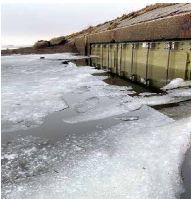
Sluseklapper på 2 styk 3000x1650 gennemløb under Gjør dige, Ulvedybet, Gjør.
