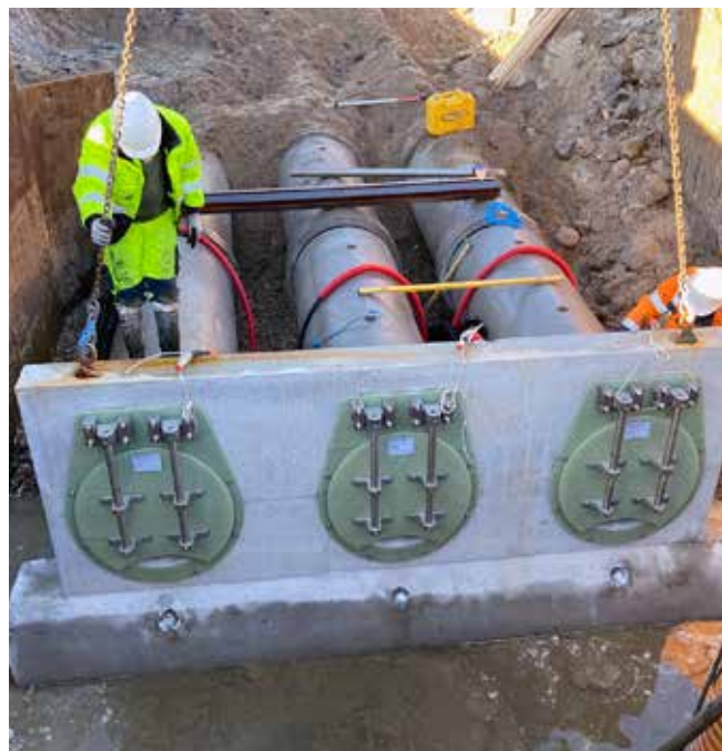
Graveklapper på 3 styk Ø700 udløb ved Nyborg Lystbådehavn, Nyborg.
